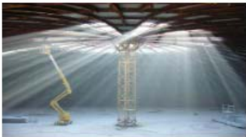
Tanque de GNL de 150.000 m 3 de capacidad
