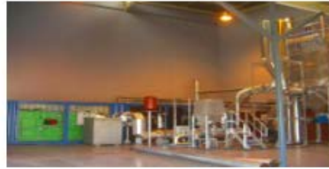
Incinerador de residuos hospitalarios
