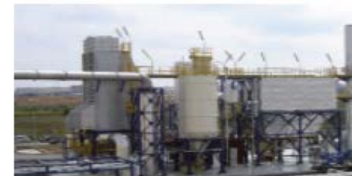
Incinerador de aceites usados
