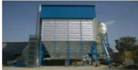
Fundición de recuperación de plomo
