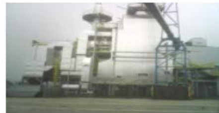
Caldera de biomasa
