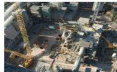
Montaje Línea de Clinker
