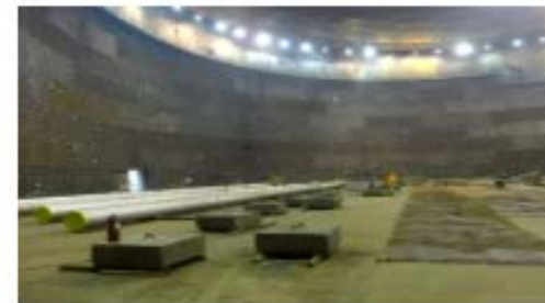
Tanque de GNL de 175.000m 3 de capacidad
